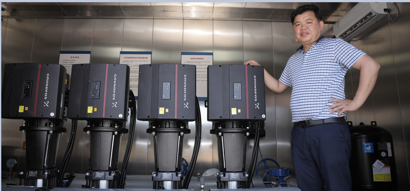
广西南丹城乡水务有限公司的工程技术部部长黄庆运在一体化智慧泵房内
